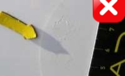
Mauvaise réparation : peinture au pinceau
